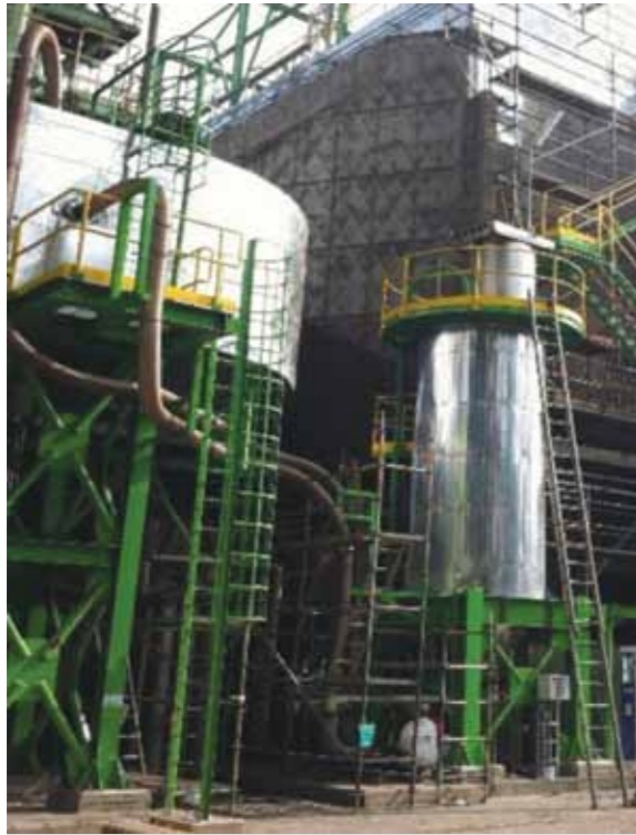
Şekil 5: Filtre öncesindeki bir Kuru enjeksiyon ünitesinin resmi -130 MW Termik Santral -- Tocopilla, Şili
