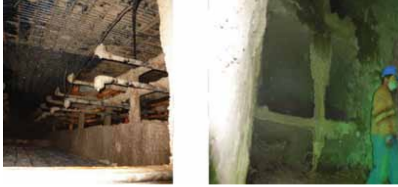
Şekil 2: FGD kurulumundaki tıkanma örneği: Sağda nozullar, solda tepsiler ve kanallar
