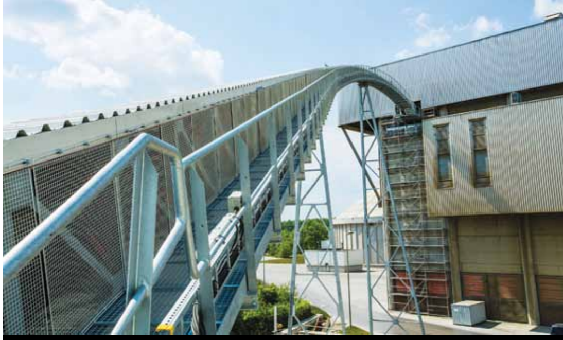
Resim 6: Gösterilen boşaltma istasyonu 26 metre yüksekliğindedir. Malzemeler buradan ana yakıcının besleme sistemine aktarılıyor. Picture 6: The discharge station shown is at a height of 26 metres. Here the material is transferred onto the feeding system for the main burner.
