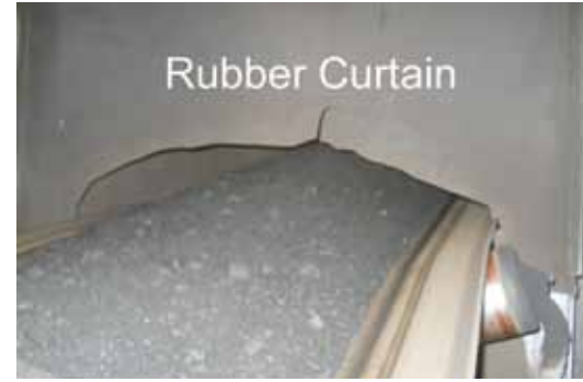
Şekil 7. Giriş ve çıkış perdeleri. Figure 7. Entry and exit curtains
