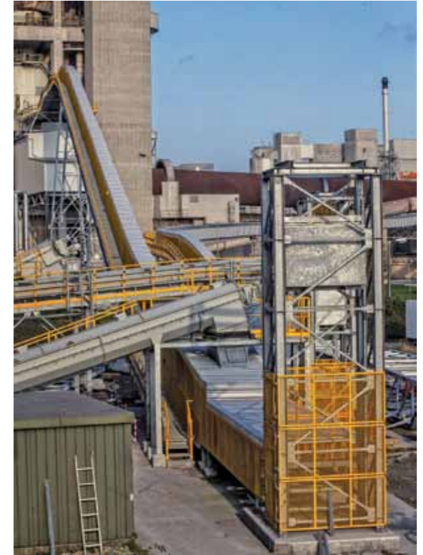
Şekil 2: Boru konveyörün kalsinatöre giden besleme istasyonu: Kıçta bir germe düzeni monte edilmiştir.
